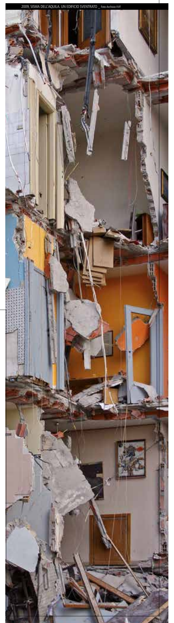
2009, SISMA DELL'AQUILA. UN EDIFICIO SVENTRATO - Foto Archivio VVF
