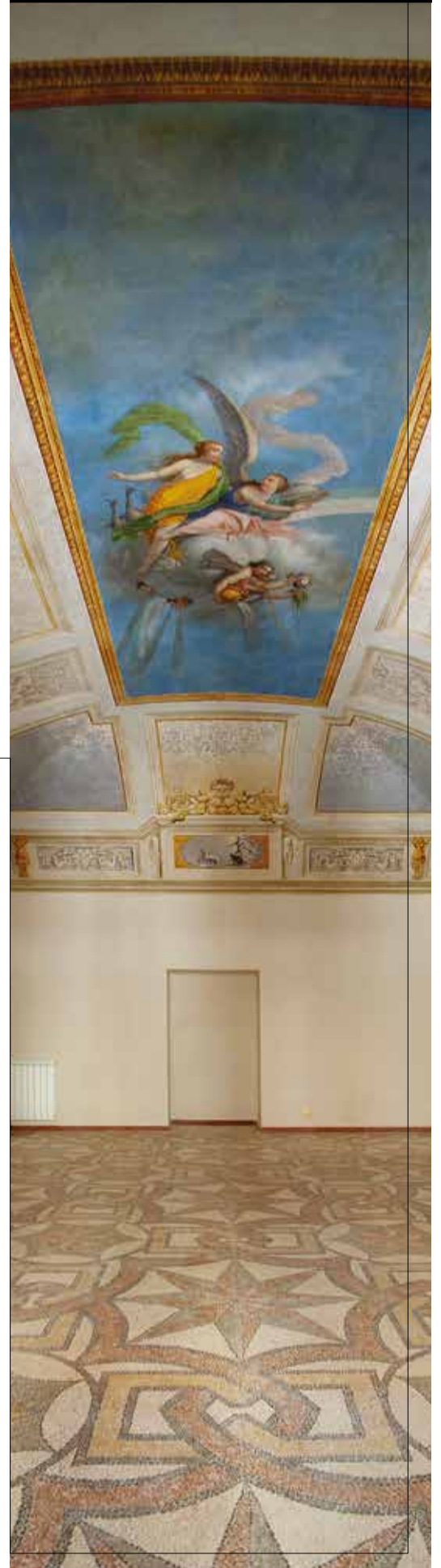
PALAZZO CAPPA CAPPELLI. UN SALONE DEL PIANO NOBILE COL RESTAURO ULTIMATO SIA DEL PAVIMENTO IN SEMINATO ALLA VENEZIANA CHE DEI DIPINTI DELLA VOLTA Foto di Roberto Monasterio per Consorzio DVC & Stewer
