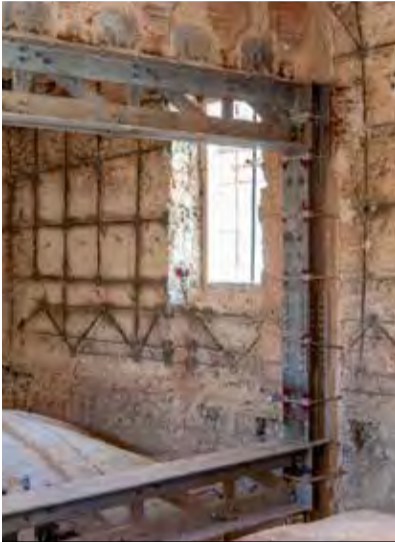
INTERVENTI DI CONSOLIDAMENTO E DI MIGLIORAMENTO STRUTTURALE DELLE MURATURE PORTANTI HANNO INTERESSATO TUTTI I PALAZZI DEL CENTRO STORICO Foto Archivio Impresa Frezza A. e P. spa
